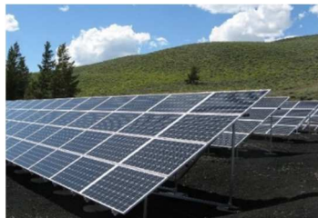
Fig. 3. Panoul solar fotovoltaic
